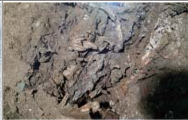
도로하부 노체 성토시 생활 폐기물 매립
