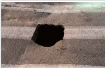
용산구 효창원로 도로함몰 발생('16.1) (효창공원역 경의선~6호선 연결통로 설치공사)
