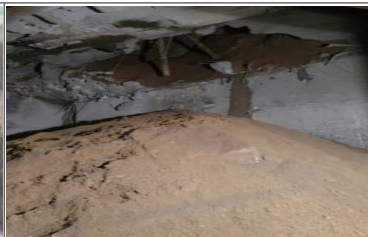
기존 6호선 연결통로 구조물 가벽 전면 뒷채움재(모래)가 터널 내부로 쏟아짐 (경의선-6호선 연결통로 접합구간)
