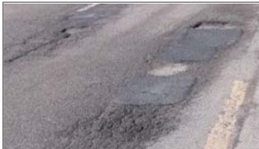
'18.2, 포트홀 발생 (주변포장에 균열 없음) [긴급보수포장 관리기법으로 보수] 1차 긴급보수 : 포트홀에 상온아스콘 포설 2차 항구보수 : 손상면적의 3배 이상 절삭·재포장
