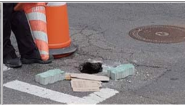
'18.3, 도로함몰 발생 [긴급보수포장 관리기법으로 보수] 1차 긴급보수 : 경미한 경우 생략 2차 항구보수 : 원인확인→원인보수→포장
