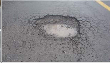
'17.4, 포트홀 발생 [긴급보수포장 관리기법으로 보수] 1차 긴급보수 : 포트홀에 상온아스콘 포설 2차 항구보수 : 손상면적의 3배 이상 절삭·재포장
