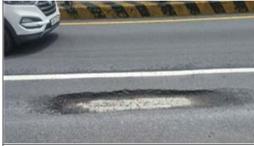
'17.7, 포트홀 발생 [긴급보수포장 관리기법으로 보수] 1차 긴급보수 : 포트홀에 상온아스콘 포설 2차 항구보수 : 최소 4㎡ 이상 절삭·재포장
