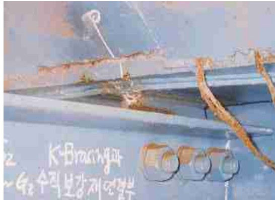
<가로부 연결보강재 균열>
