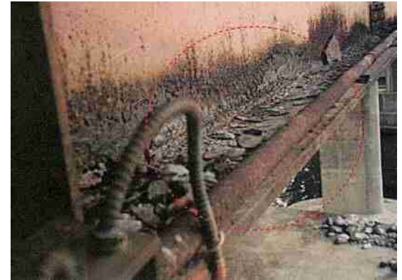
<신축이음 하단 거더 부식>
