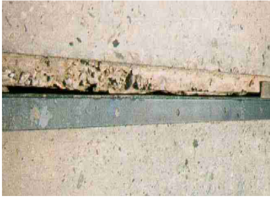
<본체 앵글 파손>
