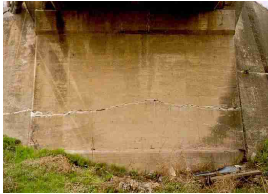
<구체 횡방향 균열>
