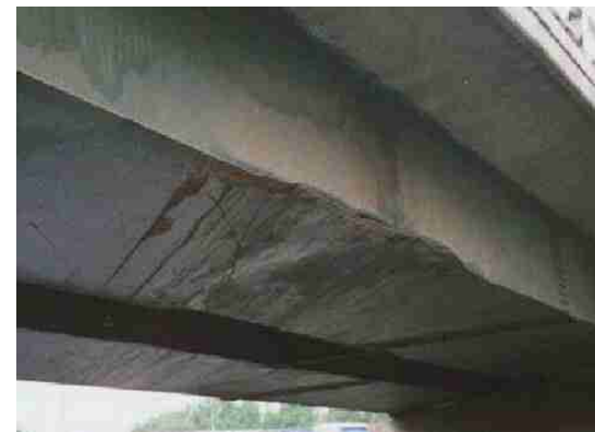
<박스 충격 파손>
