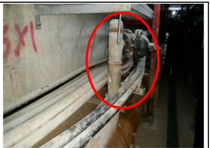
종합안내소 앞 지하공동구 고압전선 관통 잡용수배관 누수
