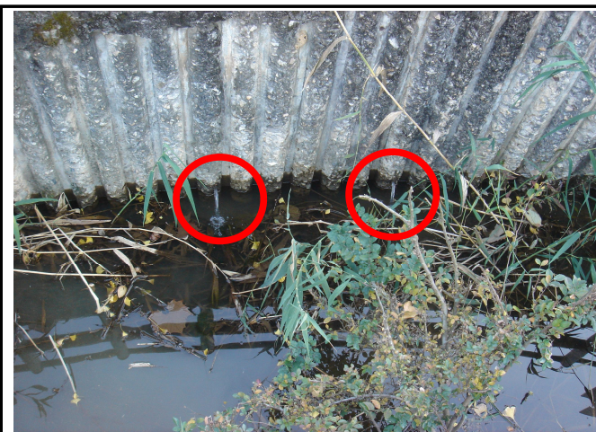
대동물관 코끼리 방사장 모트로 잡용수 누수 분출
