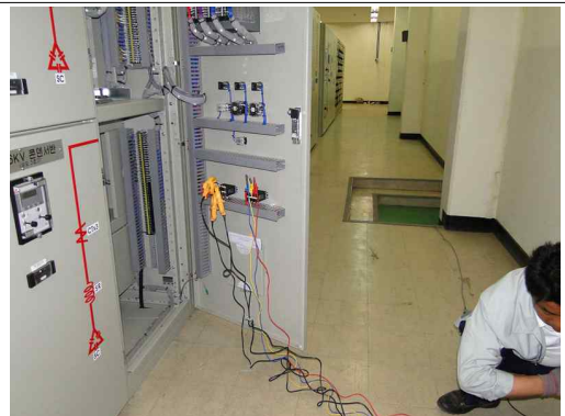
[사진6] 전압 및 전류 측정 센서
