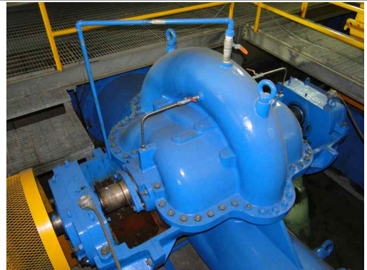
[사진8] 대방 5호기 펌프
