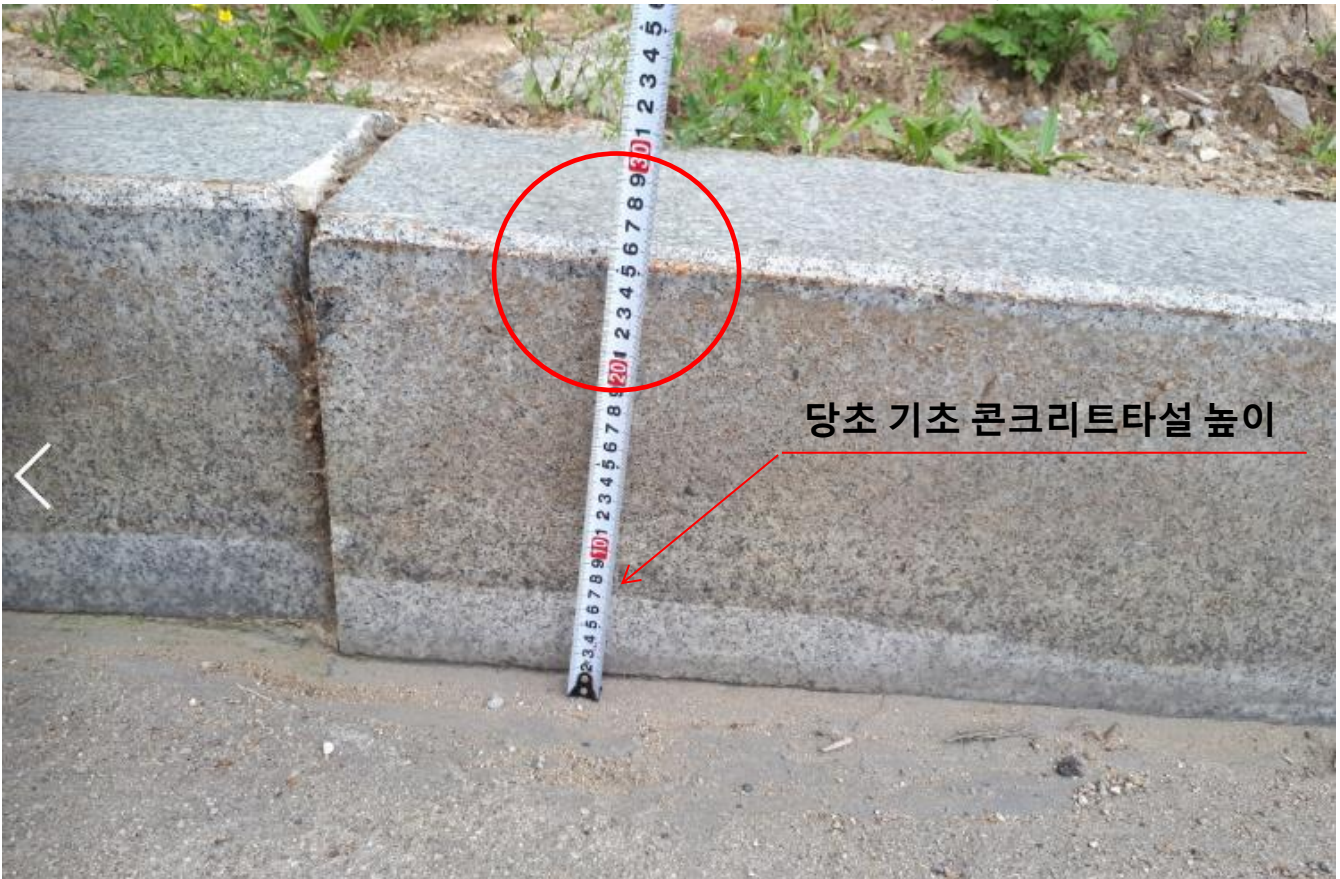
사진설명 : 경계석 하단부 측구침하 흔적(약 7.0cm침하), 경계석이 완전히 노출됨
