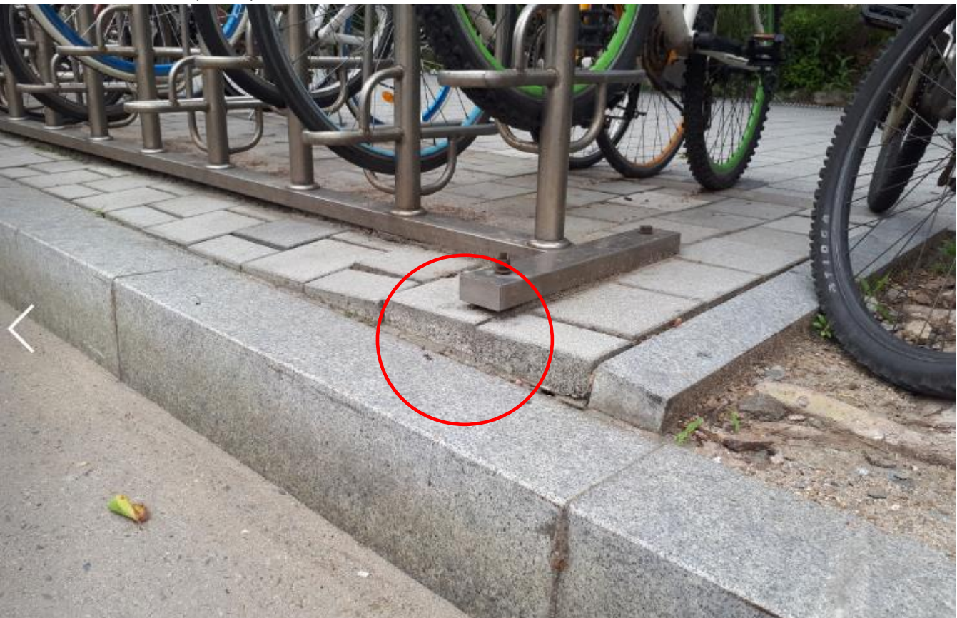
사진설명 : 띠녹지 부분 가로수분 주변은 침하되지 않고 자전거보관대 중앙부가 침하됨
