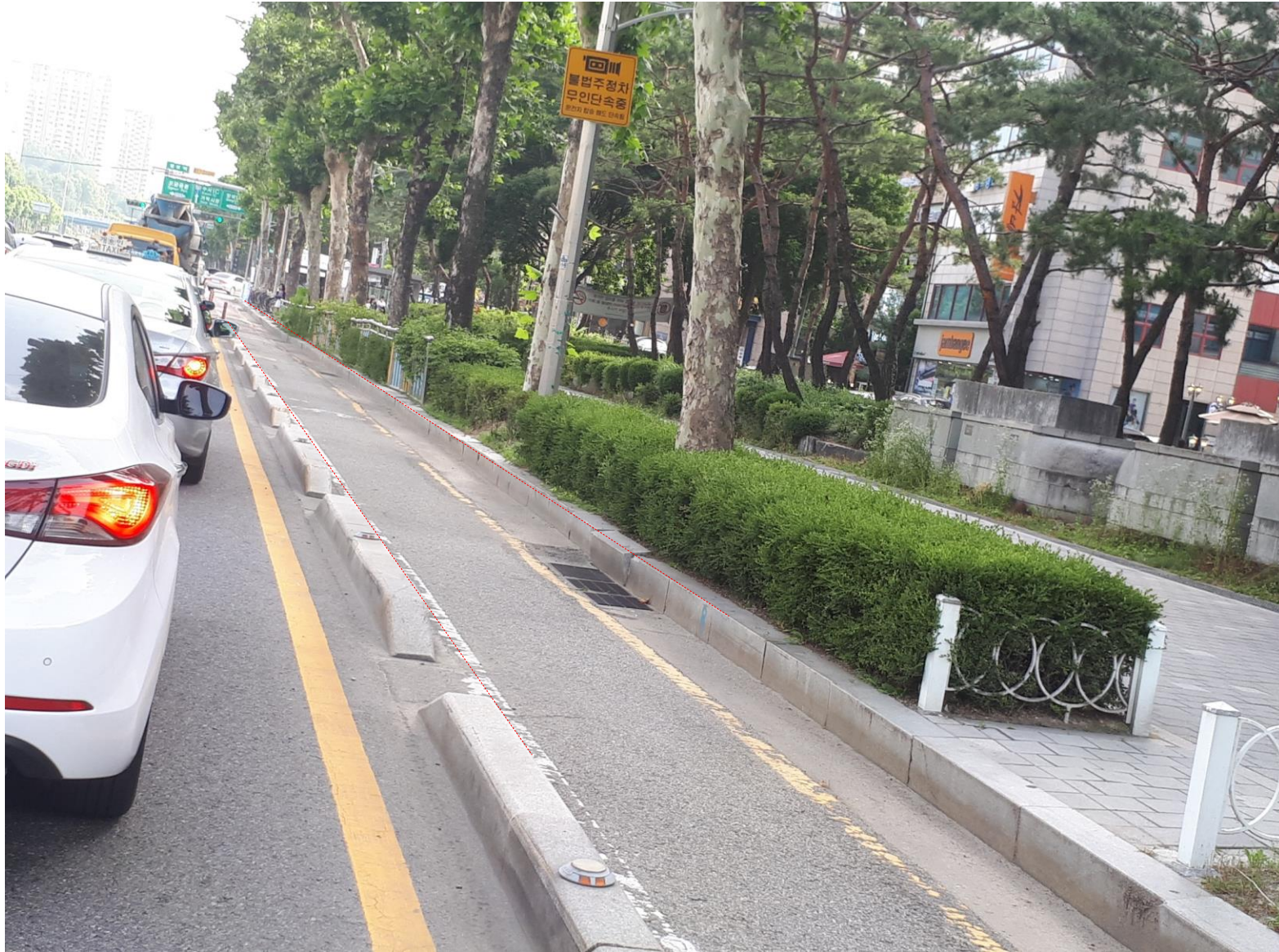
자전거도로 경계석은 일정한 종단선형을 이루고 있으나 측구(보차도경계석) 침하의 정도에 따라 종단선형이 불규칙한 상황임
