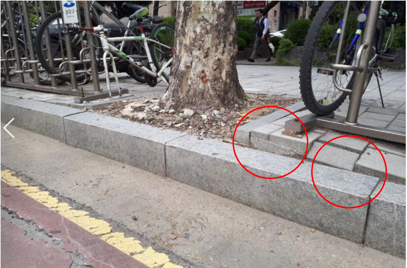
사진설명 : 가로수분과 자전거보관대기초는 침하되지 않았으나 경계석, 측구, 띠녹지부분 보도블럭 침하
