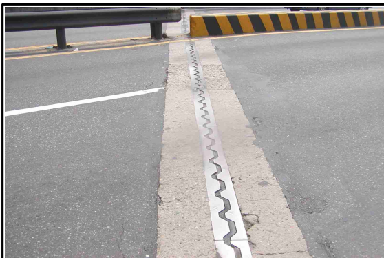
【사진 I .2.5】 신축장치 후타재 균열, 파손
