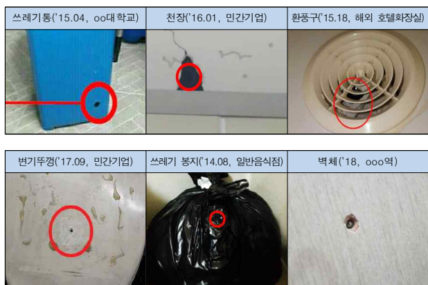
<화장실 불법촬영 기기 설치 예시>
