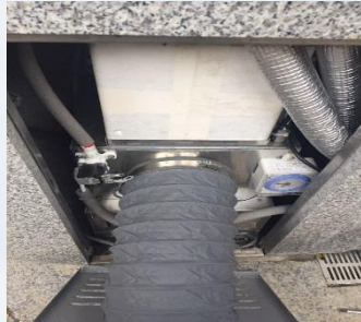
GTZSD-WD100 점검구 분리 상태
