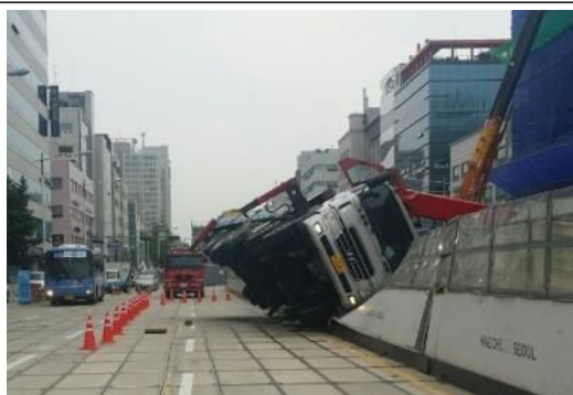
2016.10.1. 9호선 3단계 1구간 크레인 전도
