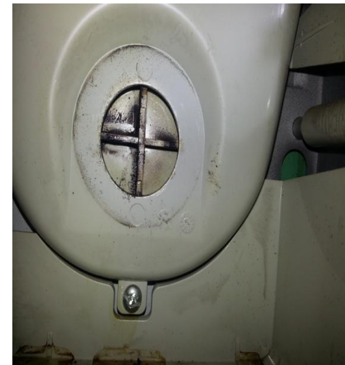
감지기 흡입구 오염사진
