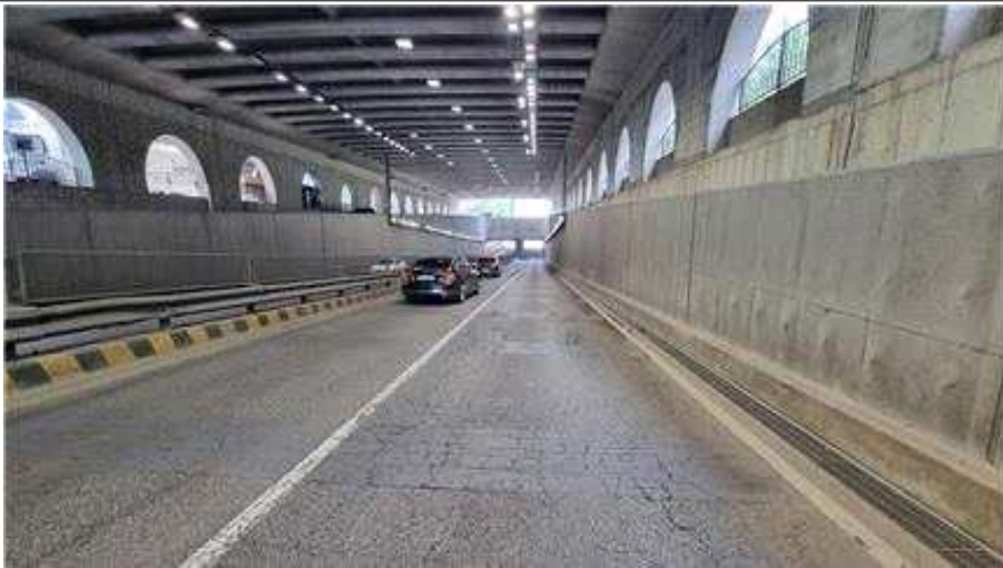
교면포장부 망상균열 및 노후
