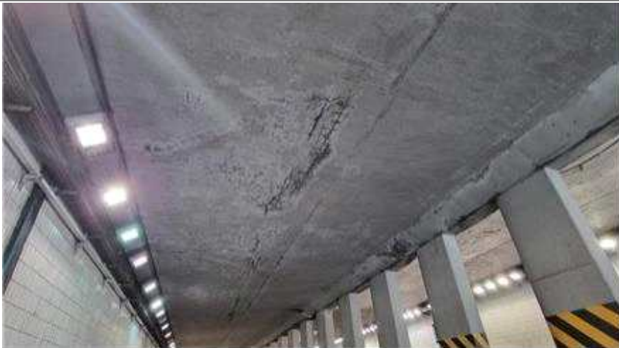
박스 슬래브 균열 및 누수
