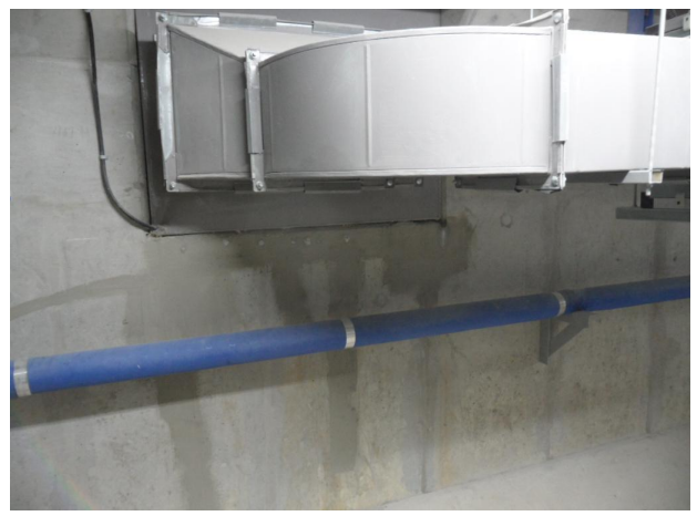
오존발생기측 배기구 누수보수 완료
