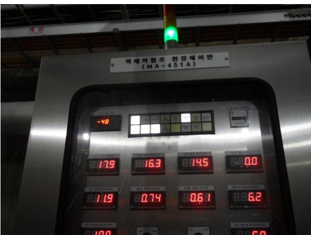
역세펌프 판넬 전류지시계 표시값 에러
