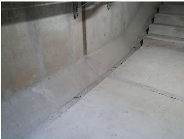
③ 오존발생기측 공동구 청소불량
