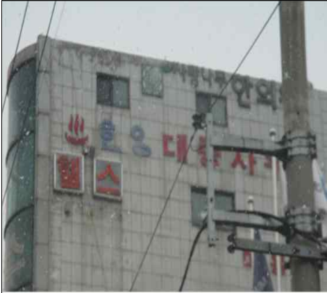
장위로127-1 [가로간판 훼손 상태]
