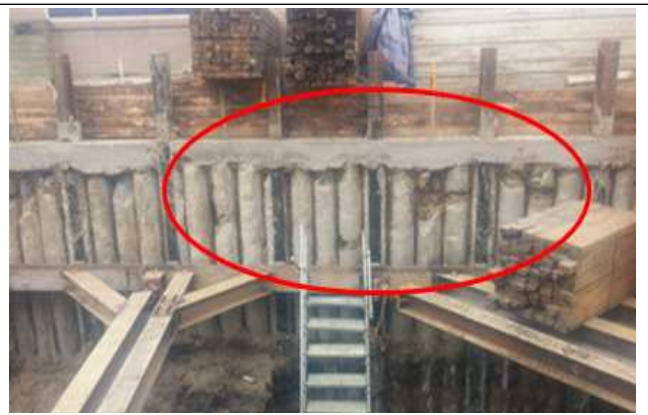
○ 위치 : 세곡동 ****번지 ○ 내용 : CIP 단면손실부 보완 필요
