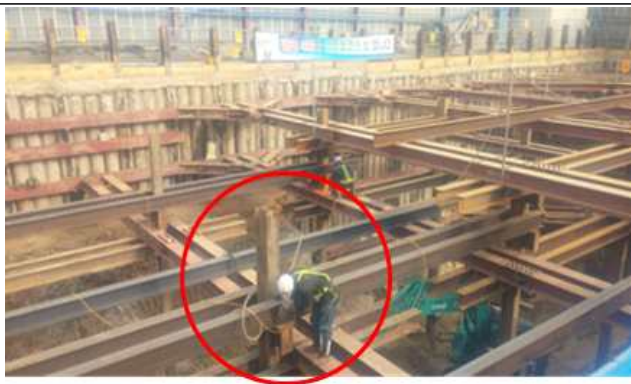
○ 위치 : 세곡동****번지 ○ 내용 : 고소 작업자 안전로프 설치 요망
