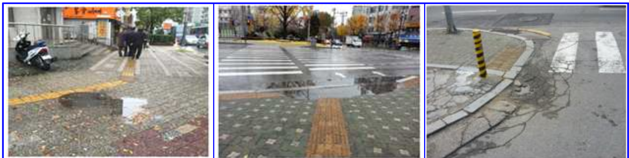
소규모 침하 · 평탄성 불량으로 인한 물고임
