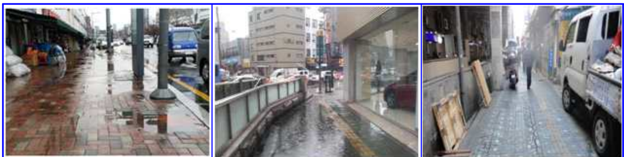
광범위 침하 · 평탄성 불량으로 인한 물고임
