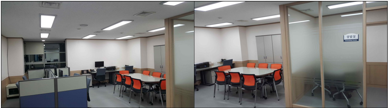
드림스타트센터 내부(상담실 내 분전함 설치)
