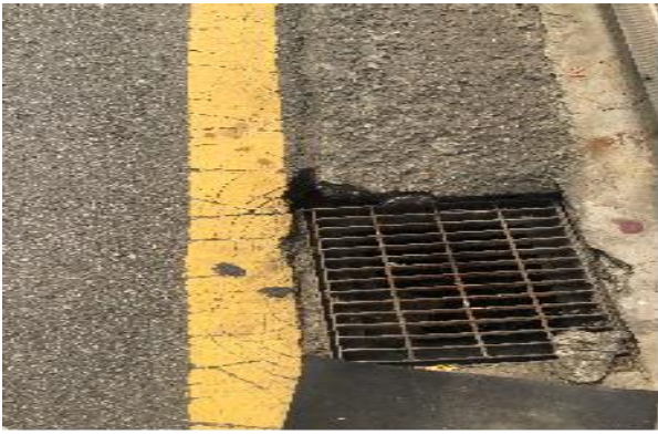
삼성로 빗물받이 주변 파손
