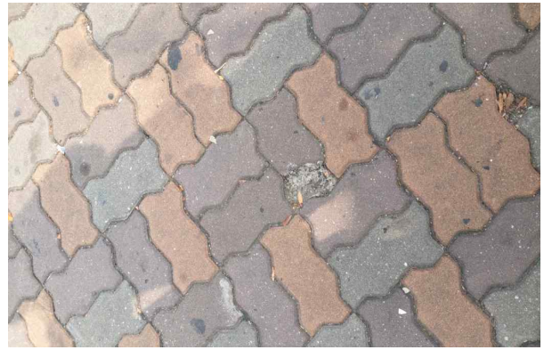
청담역 8번출구 앞 보도 파손
