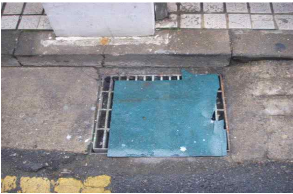
논현동 이면도로 빗물받이 덮개
