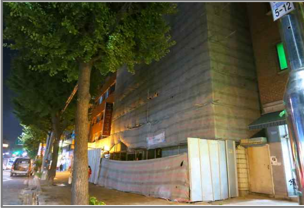
1 위치 용마산로 146 (중곡4동 18-22) 내용 안전망, 공사개요 미설치 (건축과)
