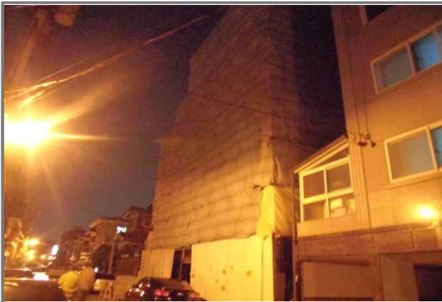
27 위치 용마산로22길 11-14 앞 (중곡4동 18-104) 앞 내용 안전망, 공사개요 미설치 (건축과)
