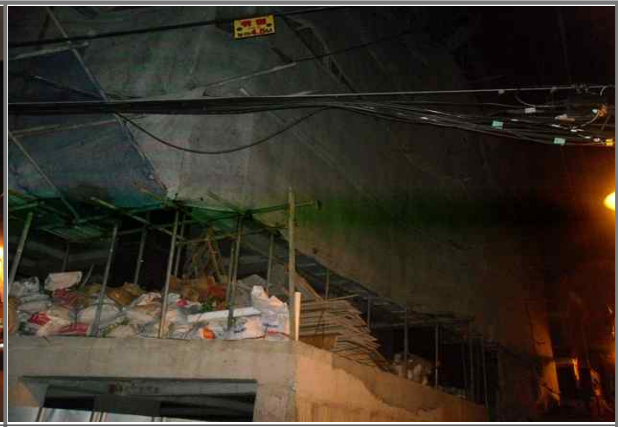
긴고랑로 158-3 (중곡4동 75-18) 낙하물 안전물 일부 형식적 설치
