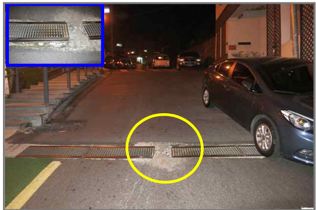
30 위치 용마산로28길 30 (중곡4동 180-2) 내용 빗물받이 측구 훼손 (안전치수방재과)
