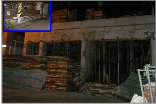
26 위치 긴고랑로44길 6 (중곡4동 74-120) 내용 건축자재 도로변 방치, 공사안내문 미설치 (건축과)
