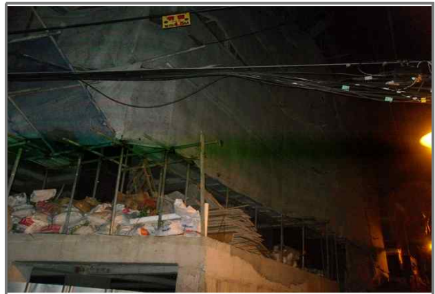
4 위치 긴고랑로 158-3 (중곡4동 75-18) 내용 낙하물 안전망 형식적 일부 설치 (건축과)
