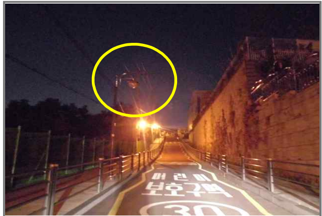
28 위치 용곡초등학교 통학로 (중곡4동) 내용 보안등 부점등 (도로과)
