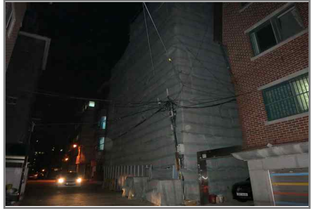
2 위치 용마산로32길 11-6 (중곡4동 288-35) 내용 낙하물 안전망 미설치 (건축과)
