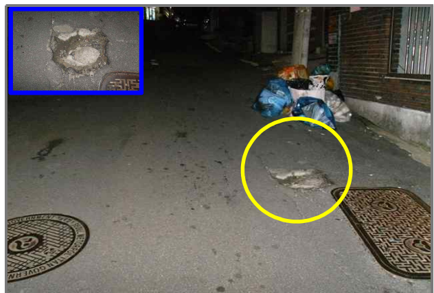
18 위치 영화사료3가길 16 (중곡4동 100-2) 내용 도로파손 (도로과)
