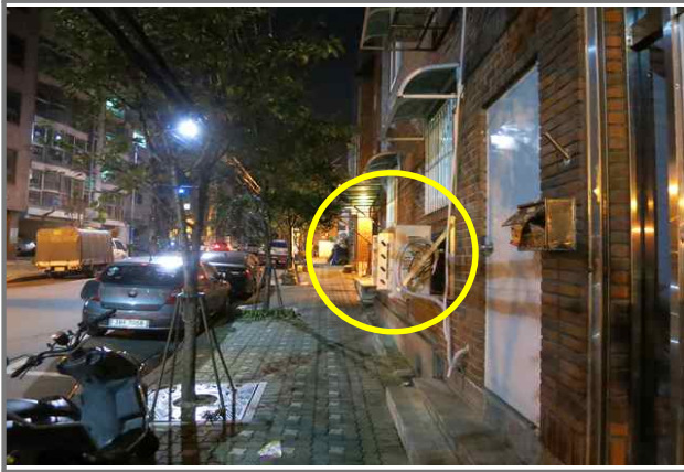
13 위치 긴고랑로 166 (중곡4동 74-32) 내용 에어컨실외기 돌출 (건축과)
