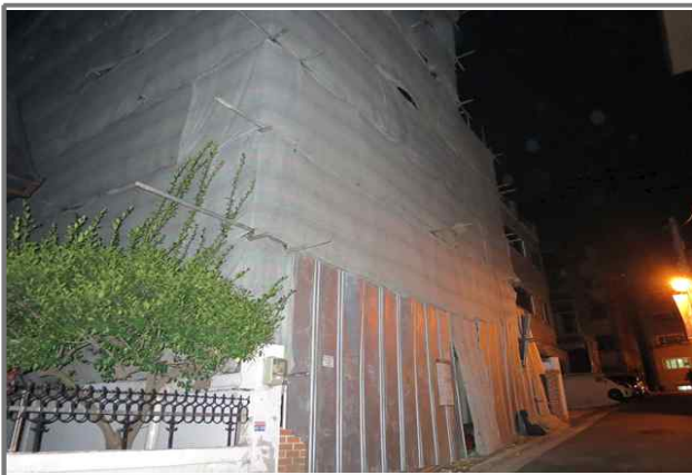
3 위치 용마산로32길 25-5 (중곡4동 288-17) 내용 낙하물 안전망 미설치 (건축과)
