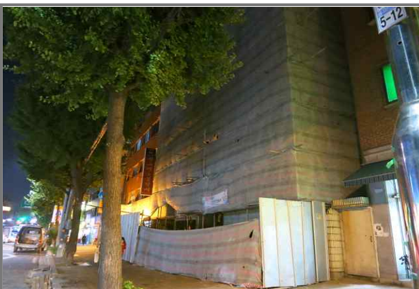
용마산로 146 (중곡4동 18-22) 낙하물 안전망 및 공사안내문 미설치
