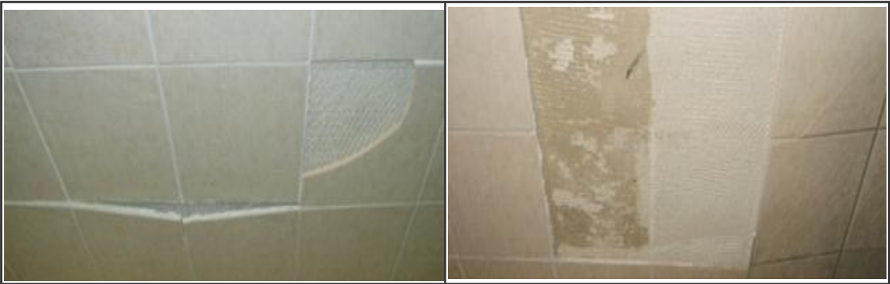
화장실 타일 파손부
