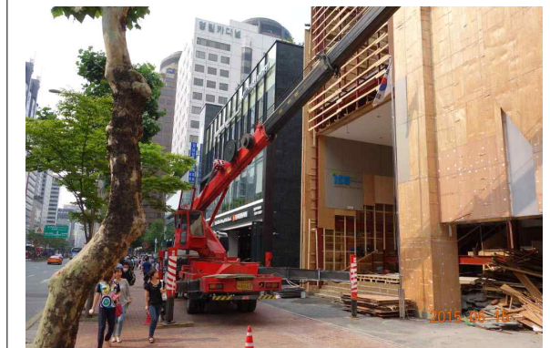
감사담당관 - 보도 무단점용 크레인 적발 및 조치
