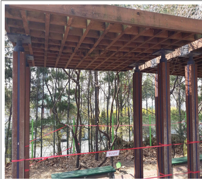
위쪽에 물이 고여있어 등나무 받침대가 부식됨
