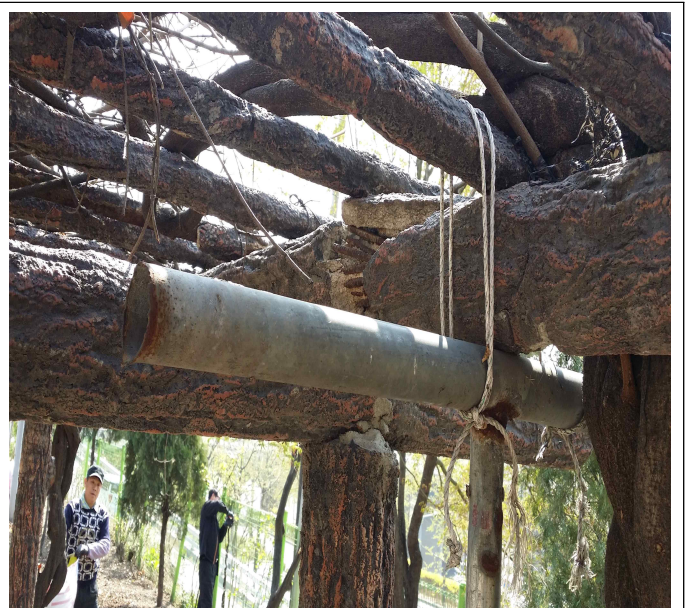
오래된 인조목 철근이 드러나 있으며 부식되어 시멘트가 떨어져 나감
