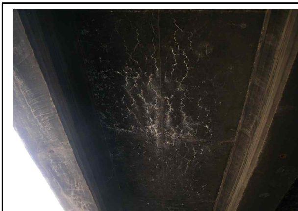
·위 치 : 바닥판 하면 ·현 황 : 망상균열, 백태 ·대 책 : 표면처리공법
