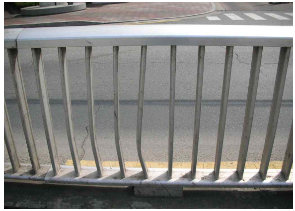
·위 치 : 난간 ·현 황 : 난간변형 ·대 책 : 재설치
