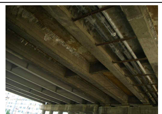
·위 치 : 주형 및 가로보 ·현 황 : 백태/누수흔적 ·대 책 : 표면처리공법
