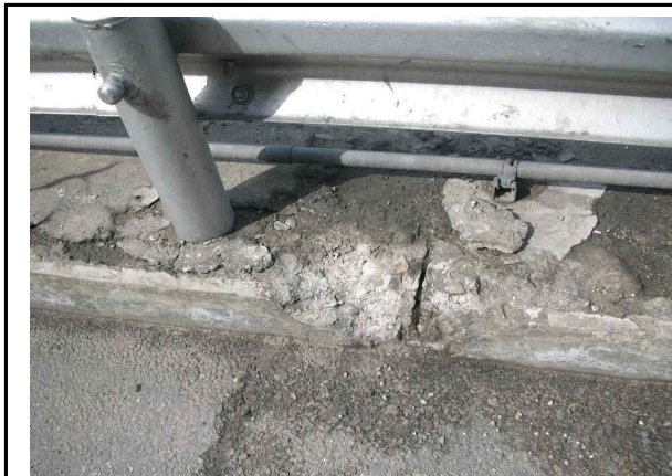
·위 치 : 연석 ·현 황 : 콘크리트 탈락 ·대 책 : 단면복구공법
