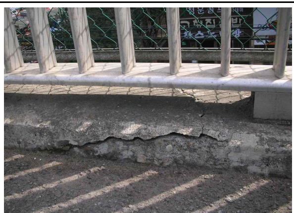
·위 치 : 연석 ·현 황 : 콘크리트 박락 ·대 책 : 단면복구공법
