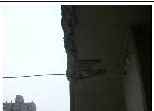
·위 치 : 바닥판하면 기존 육교 철거부 ·현 황 : 콘크리트 탈락, 철근노출 ·대 책 : 단면복구공법
