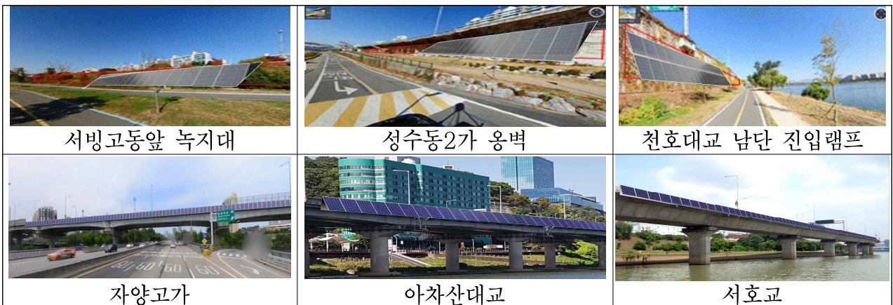
〈강변북로 6개소 태양광설비 설치도〉
