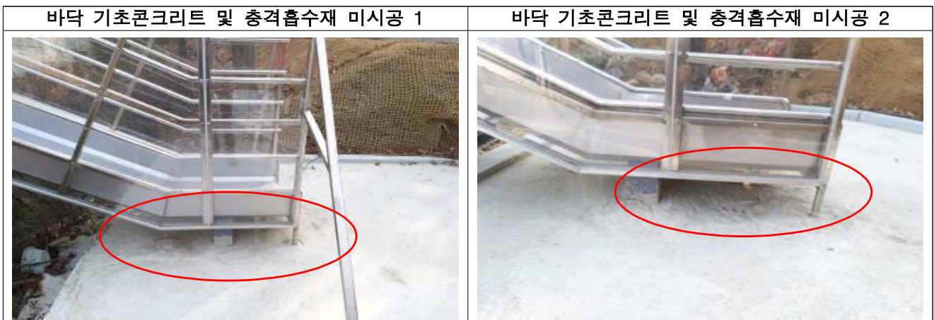
[그림 3] 미끄럼틀 설치 바닥 기초콘크리트 및 충격흡수재 미시공
