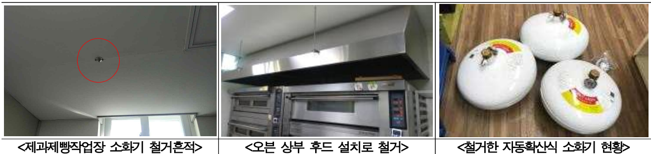
[그림 1] 자동확산식 소화기 미설치 현황
