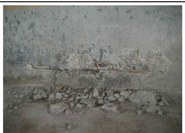
·위 치 : 교각 ·현 황 : 탈락/철근노출 ·대 책 : 철근방청+단면복구공법
