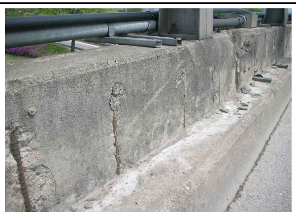
·위 치 : 연석 ·현 황 : 철근노출 ·대 책 : 철근방청+단면복구공법
