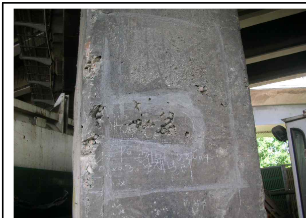
·위 치 : 교각 ·현 황 : 재료분리 ·대 책 : 단면복구공법
