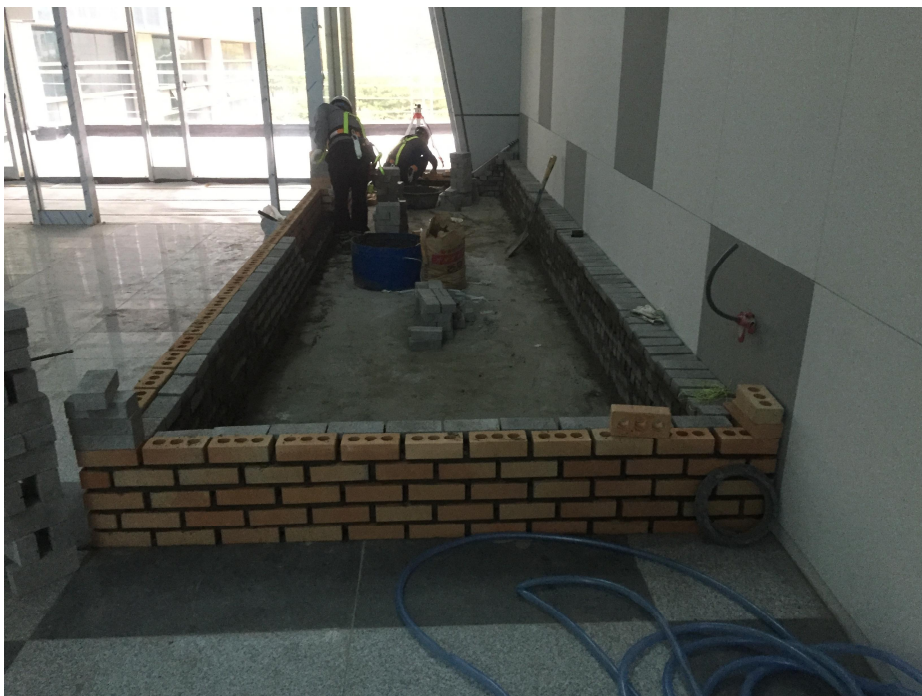
IT-Complex 대민동 3층 (식내플랜터 B)
