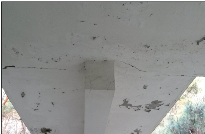
청사 4층 후면 구름다리 하부 균열
