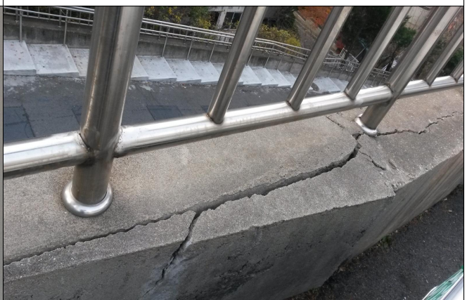
원형창고위 주차장 난간 균열
