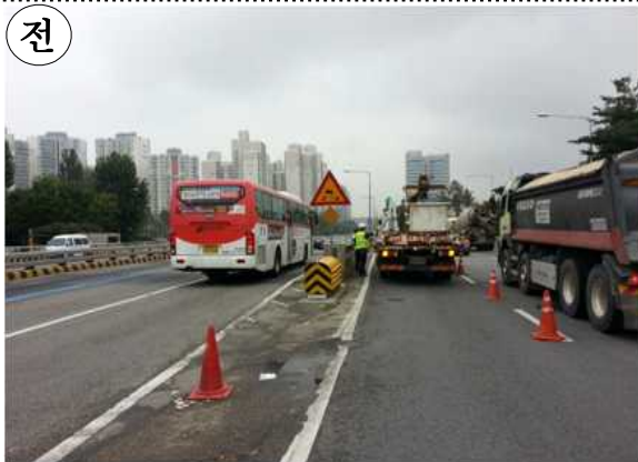
송파구 송파지하차도 가로등 설치 전
