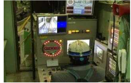
쉴드TBM 장비 조정실
