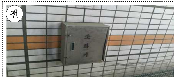
지하차도 소화기함 교체 전
