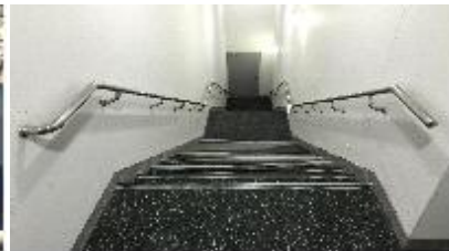
[안전] 지하볼펜 출입계단 → 핸드레일, 조명등 추가
