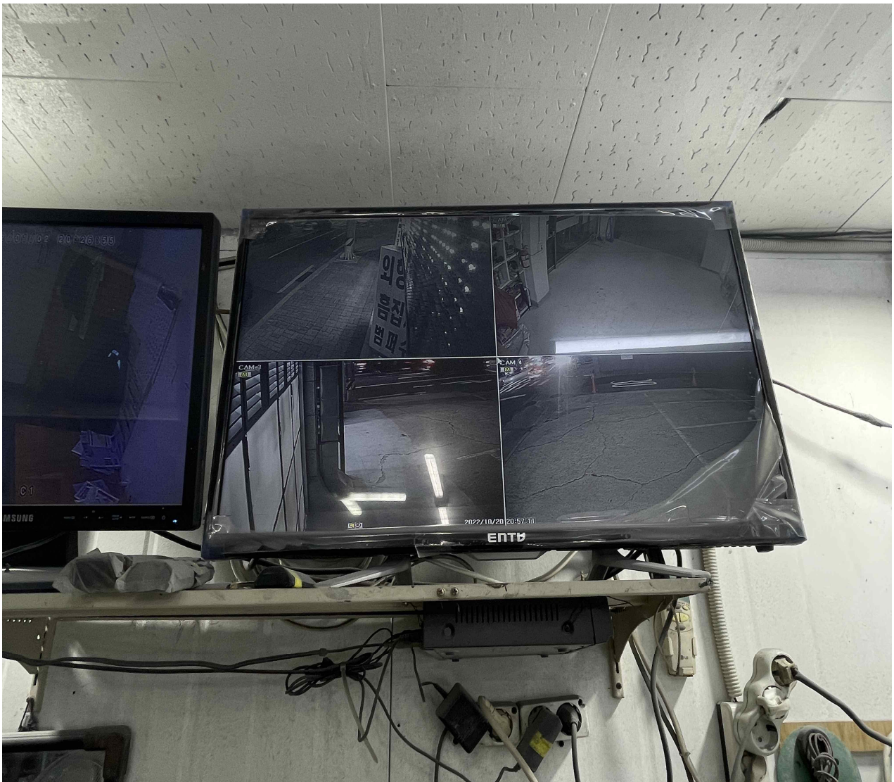
3. 사업장에 설치된 단속 감시용 CCTV
