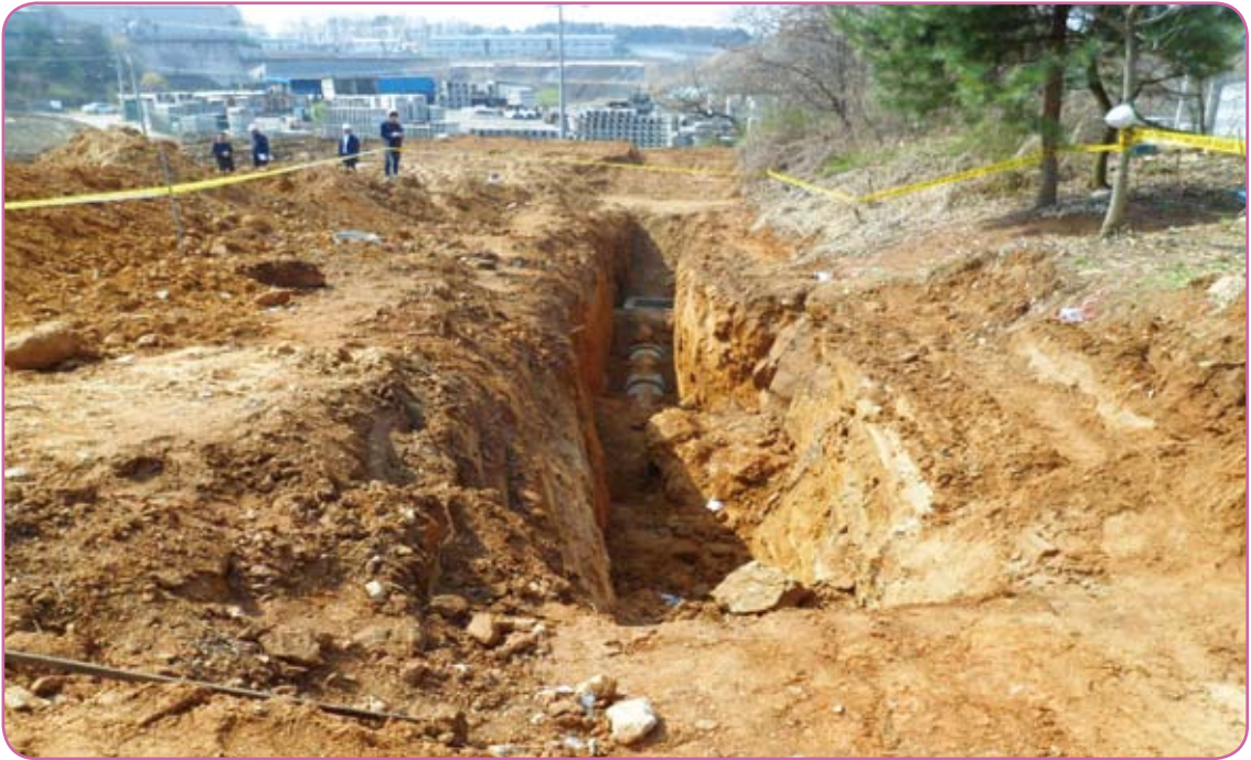
재해발생 당시 현장 전경
