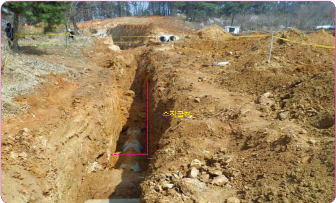
굴착면의 토사 기울기 상태(수직굴착)
