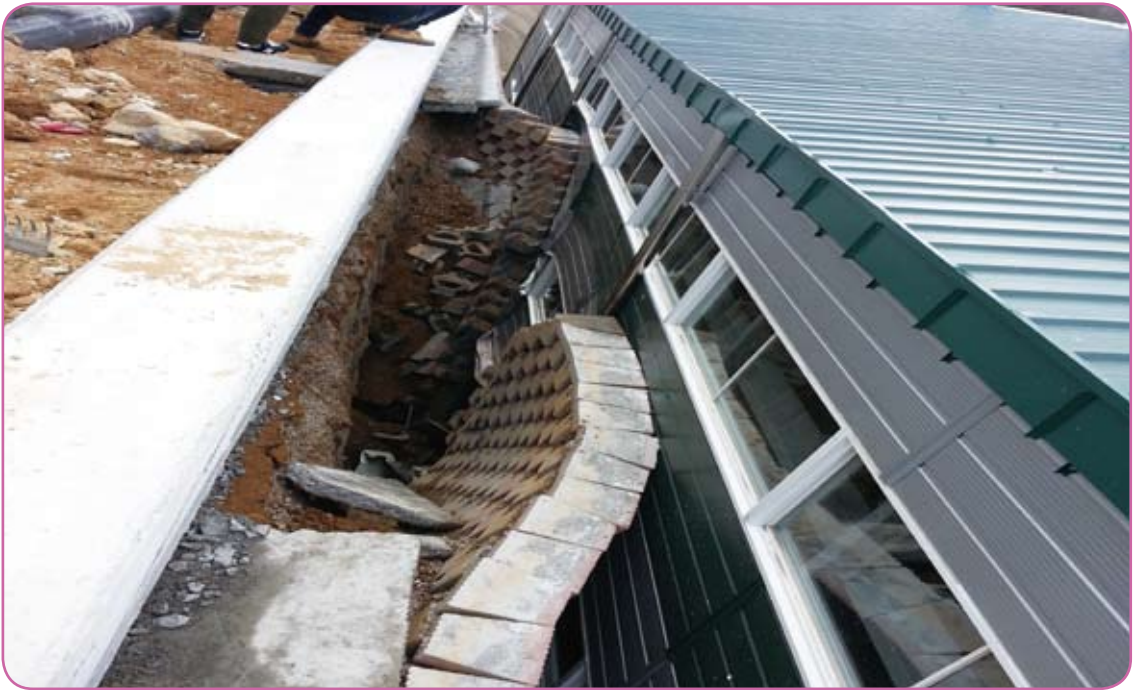
무너진 보강토 옹벽(상부)
