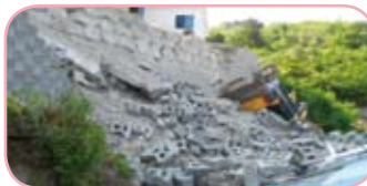
설계도서 미비, 무리한 터파기
