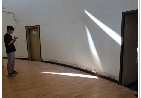
샤워실과 화장실 사이 벽체 손상
