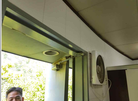
화장실 바깥 출입문 파손
