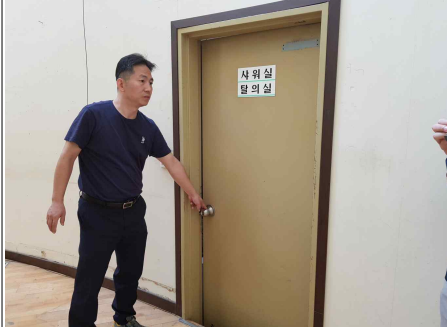
샤워실 출입문 고장
