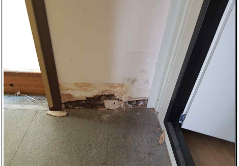
휴게실 쪽 벽체 파손
