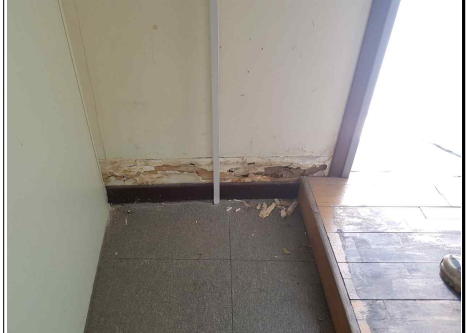
샤워실 벽체 파손
