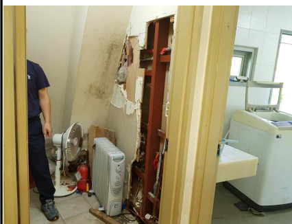
화장실 옆 보일러식 벽체 파손
