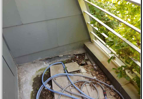
화장실 바깥쪽 타일 파손
