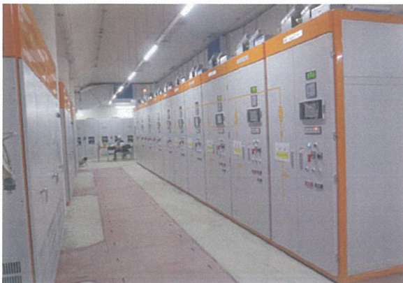
변전소 가압운전 상태 안전 점검
