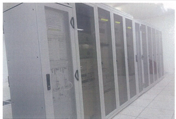
신호기계실 장비 설치상태 안전 점검
