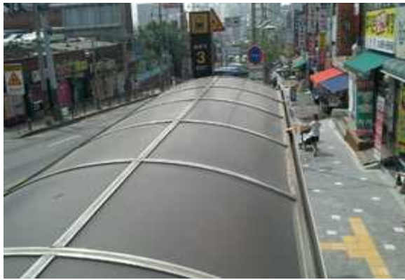
남구로역 #3출구 캐노피 유리 파손
