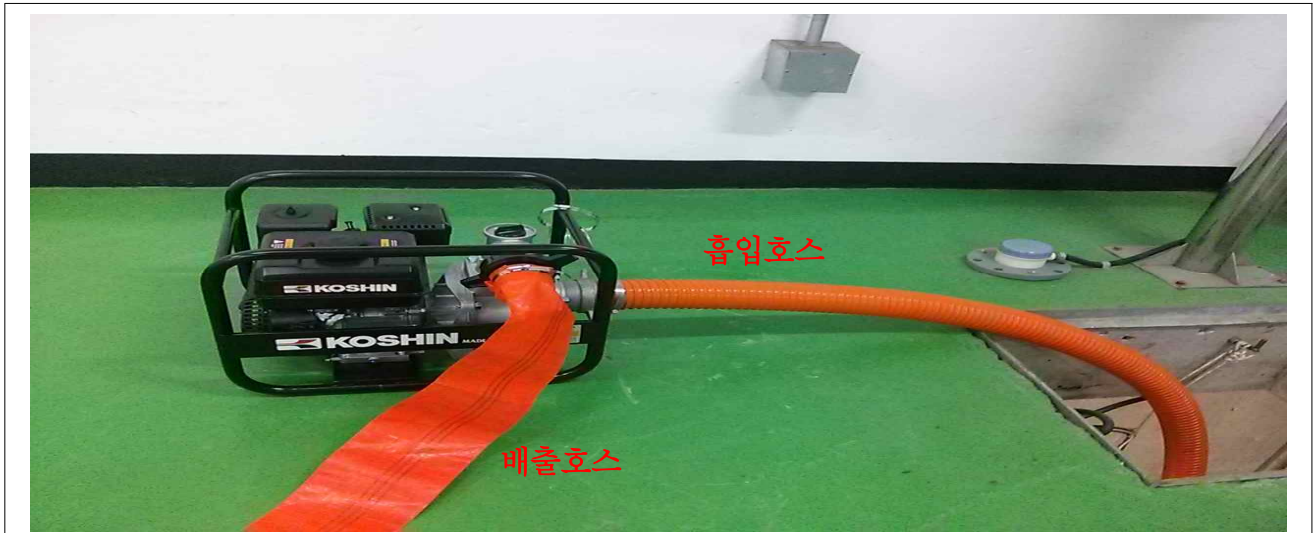
시동 걸기 전 펌프 및 흡입·배출호스 세팅 상태
