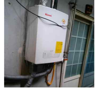
<보일러 시설> 교체 후
