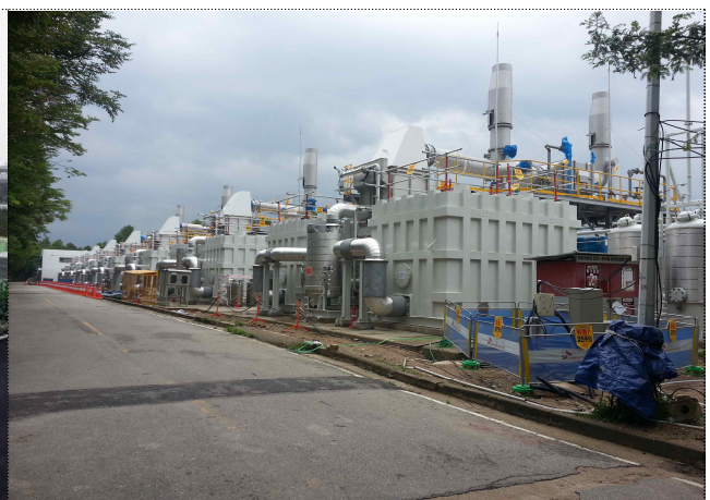
고덕그린에너지(강동구 고덕차량기지 19.6MW) ('14.10월말 상업운전)
