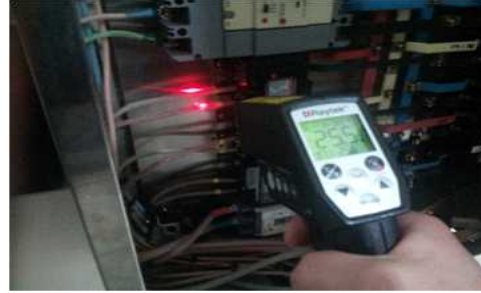
[전원케이블 발열상태 확인]
