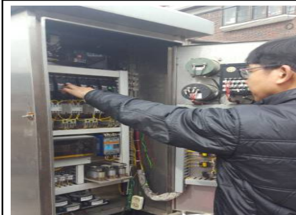
간이빗물펌프장 점검 (전기판넬 점검)
