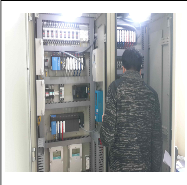
송천 빗물펌프장 자동화 설비 점검
