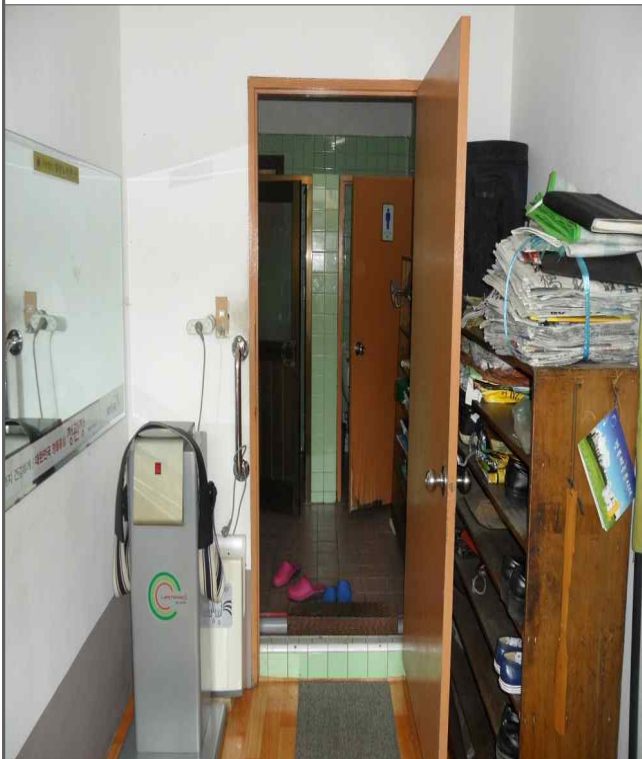
경로당 노후 화장실
