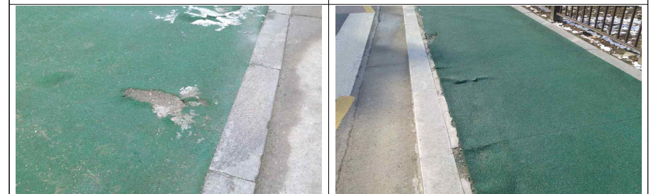
남측 탄성포장 탈락
