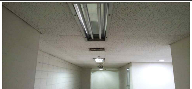
자하3층 복도 절전 후
