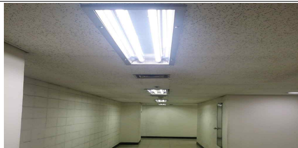
지하2층 복도 절전 전
