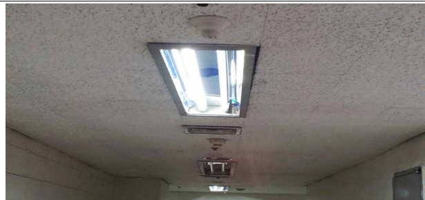
지하3층 복도 절전 전
