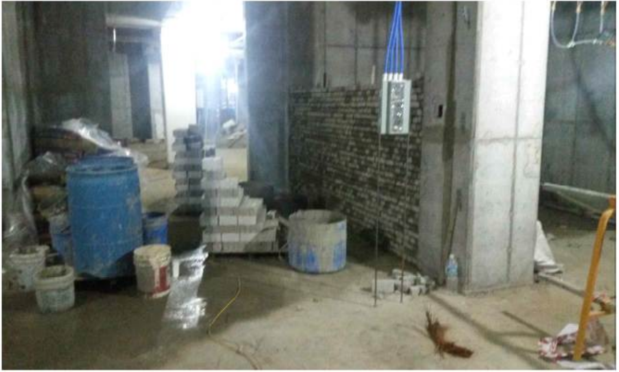
재해발생 현장 전경
