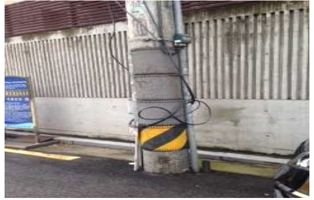
강남대로 부근 이면도로 전봇대 케이블 정비 요망
