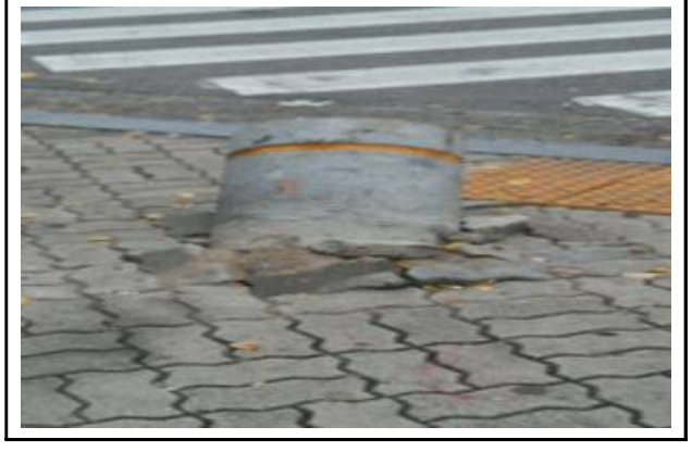
도산대로 블라드 파손
