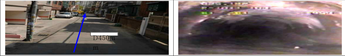
③ 성수동2가 299-140~299-187 → 관거 노후 및 가정관 연결부 파손
