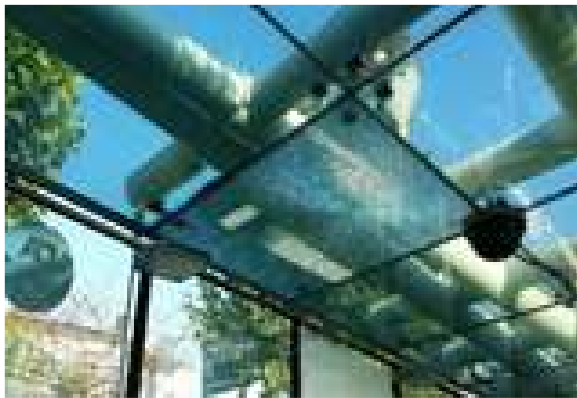
면목역 #3출구 캐노피 강화유리 파손
