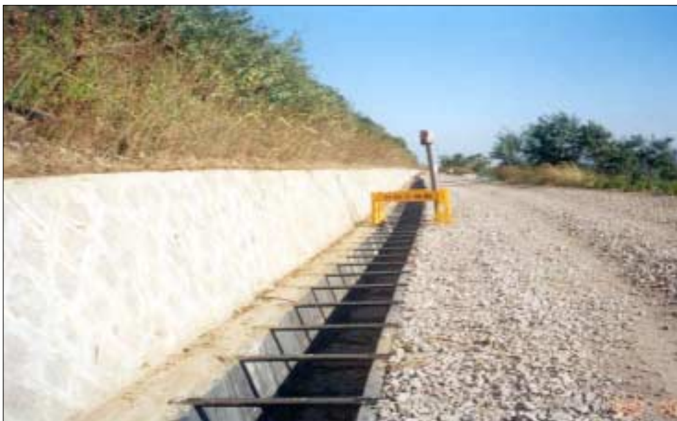
〈그림 4-5〉 중간관리도로에 설치된 우수배제 관로 (U형측구)
