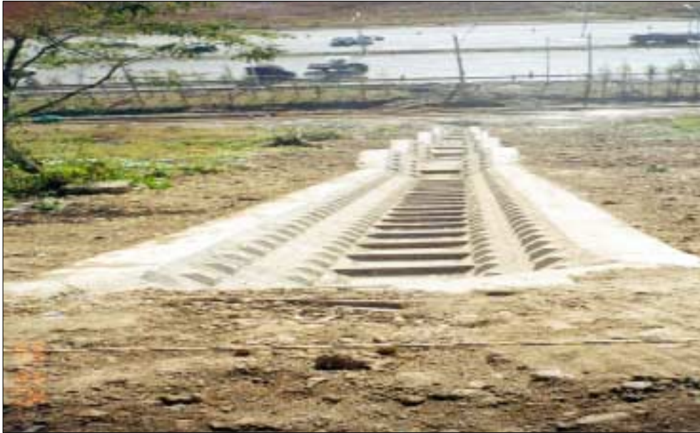
〈그림 4-6〉 사면에 설치된 우수배제 관로 (제형단면 도수로)
